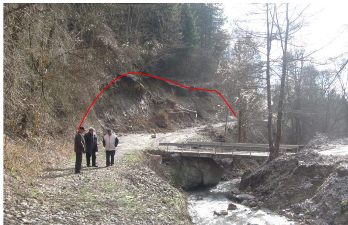
Откос с нарушена устойчивост над пътя /участък № 2/
