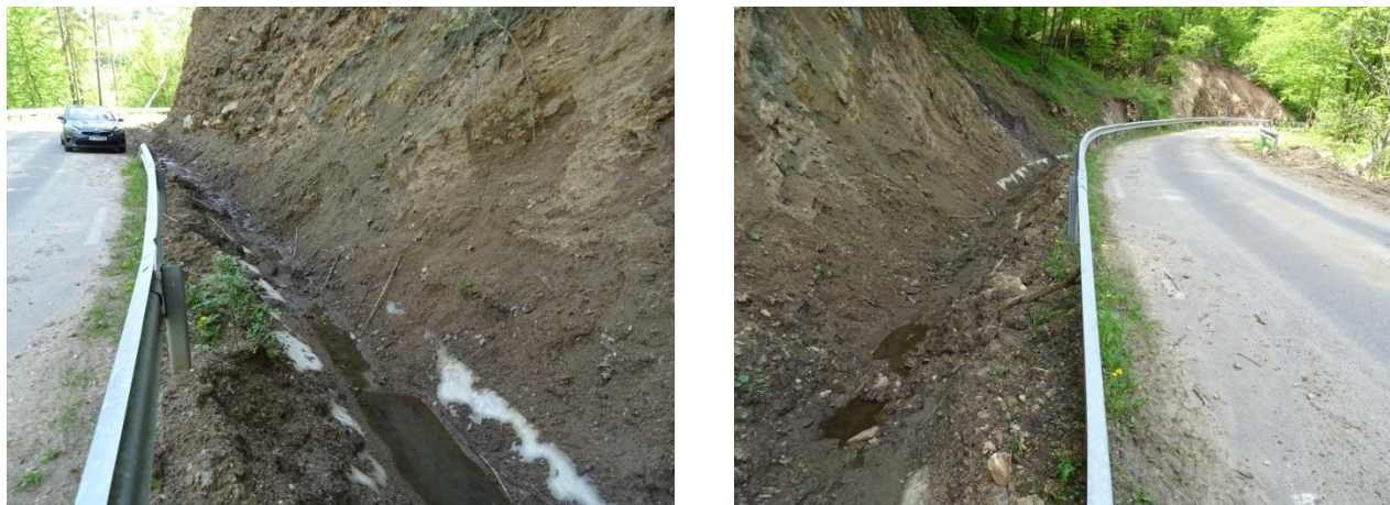
Отводнителна канавка на пътя /май, 2020 г./
