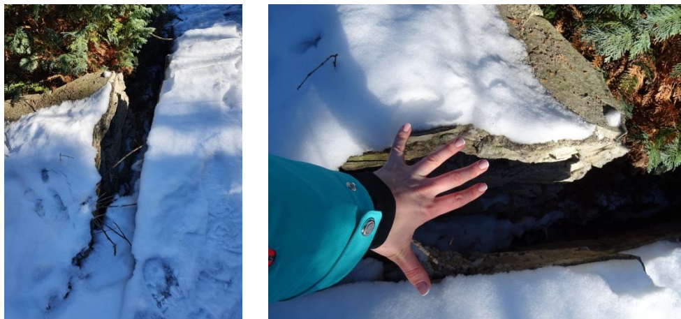
Отворена пукнатина на срязване в УПИ I-571
