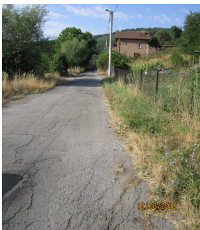
Деформирана асфалтовата настилка на ул. ”В. Левски” /2015 г./
