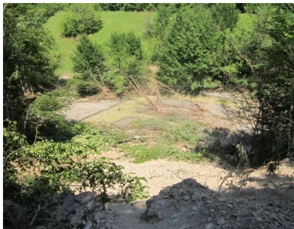
Свлачищен участък на път SFO 3611 при km 4 +150 /август, 2014 г./
