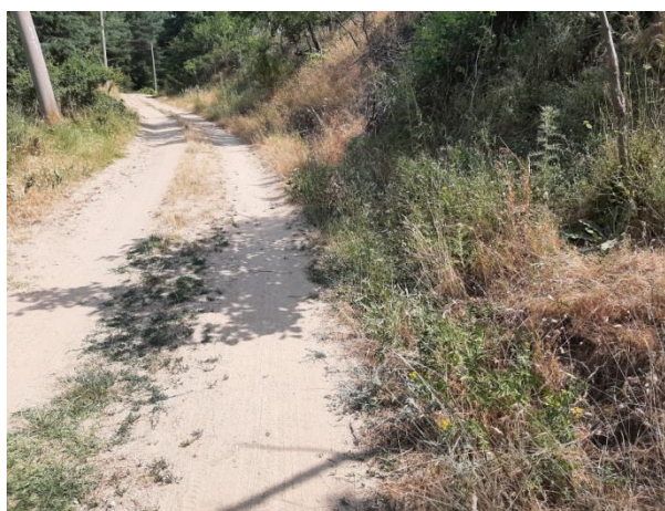
Състояние на крайпътната земна канавка
