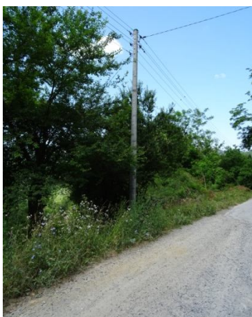
Ново изграден ел. стълб
