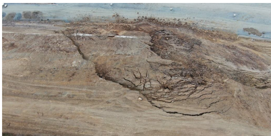
Общ изглед на откоса на засегнатия участък заснет с дрон към 13.04.2021 г.
