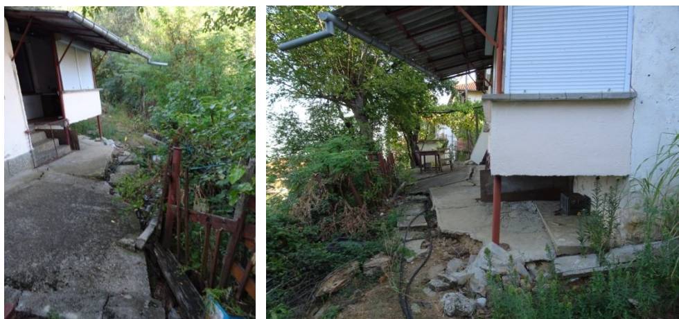
Общ изглед към засегнатия участък пред жилищната сграда
