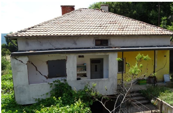
Конструктивно нарушена жилищна сграда в имот 5
