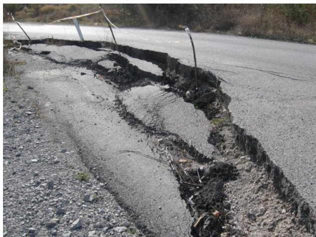
Главен свлачищен откос /2013 г./
