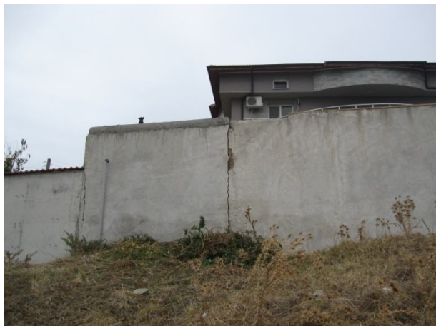
Деформации по оградна подпорна стена
