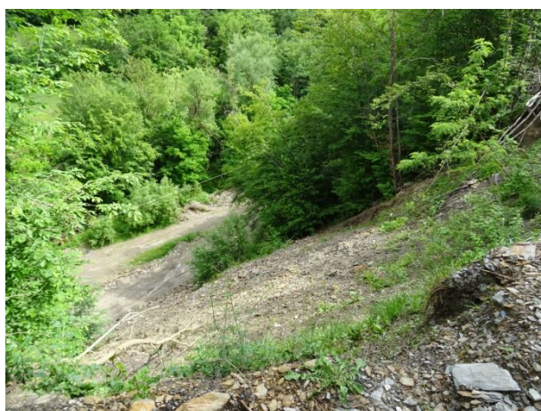
Свлачищен участък на път SFO 3611 при km 4 +150 /юни, 2020 г./
