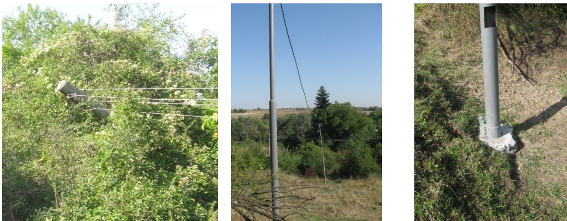
Състояние на ел. стълбове в района на свлачищното тяло
