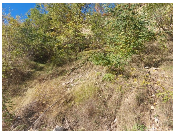
Общ изглед на свлачищния участък
