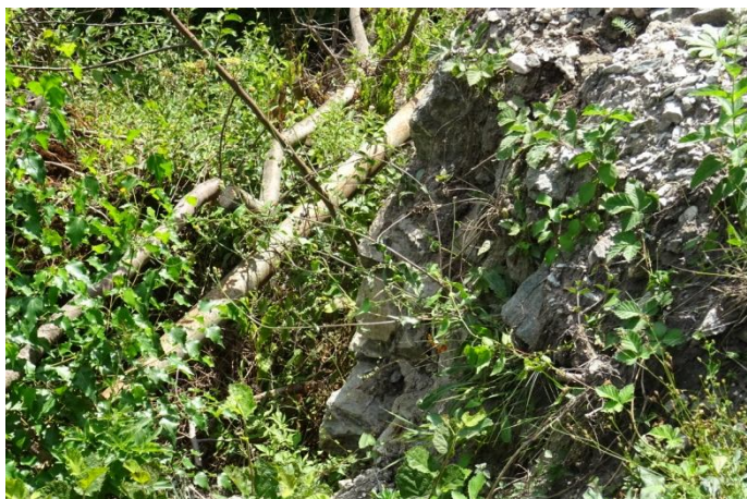
Необезопасена метална тръба, пренасяща оптичен кабел
