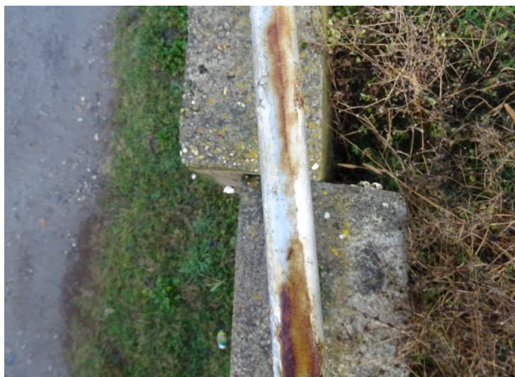
Деформации по подпорната стена
