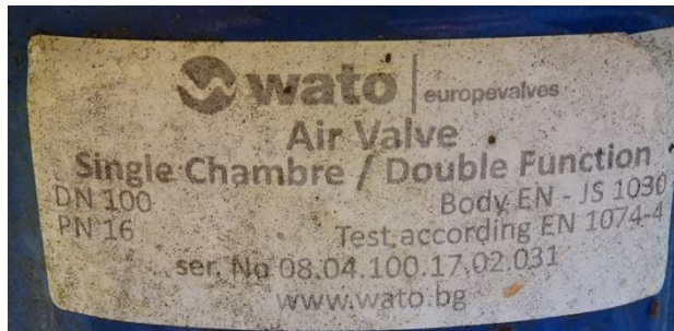
Подменен обезвъздушител /11.10.2018 г./
