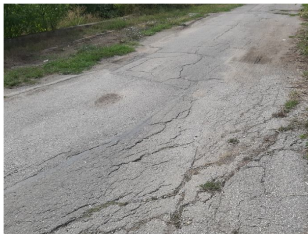
Деформации по ул. „Васил Левски”
