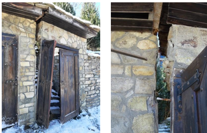
Деформация на входни врати
