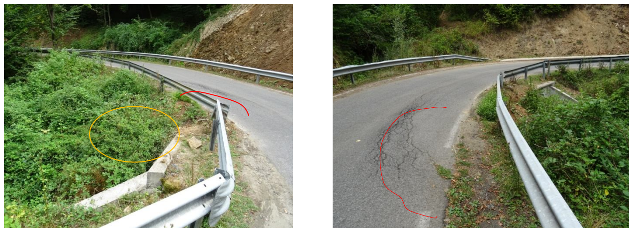
Разположение на слягането спрямо югоизточното крило на водостока
