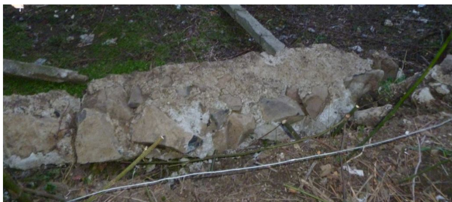
Пукнатини по терена /март, 2015 г./
