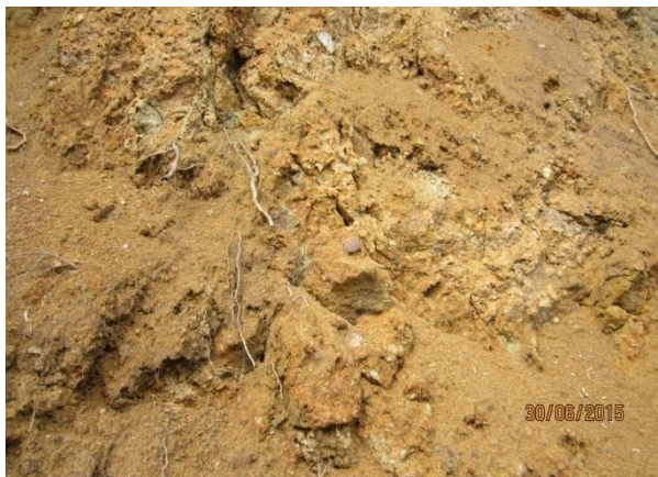
Наличие на отворени пукнатини по откоса
