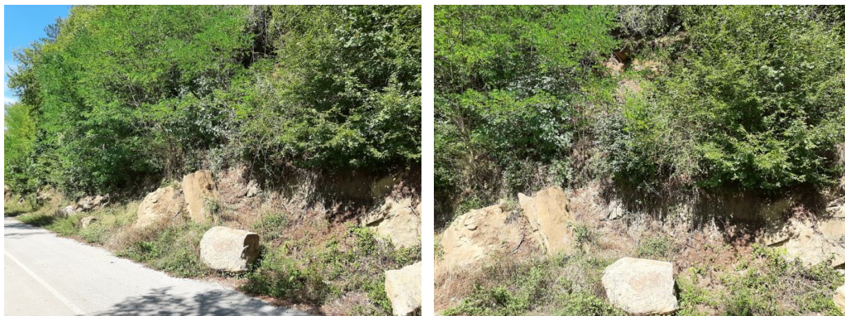
Общ изглед на свлачищния участък над пътя
