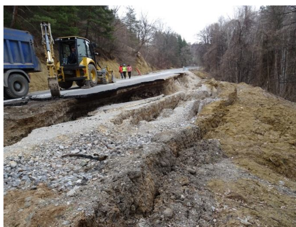
Разрушени и отместени габиони /09.03.2021 г./
