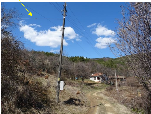
Защитен с обтегач наклонен ел. стълб
