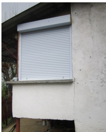
Проявена вертикална пукнатина
