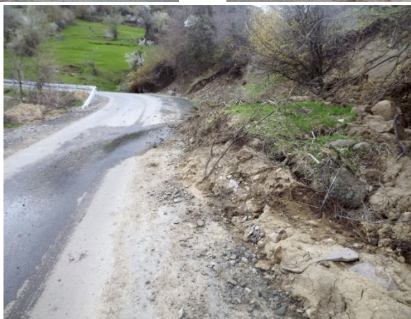
Общ изглед на свлачищния участък /април, 2015 г./
