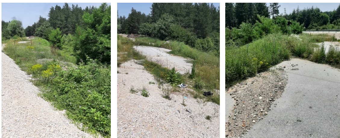
Състояние на главния свлачищен откос и старото пътно платно
