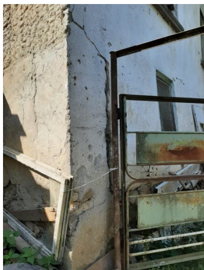
Деформации по северната фасада
