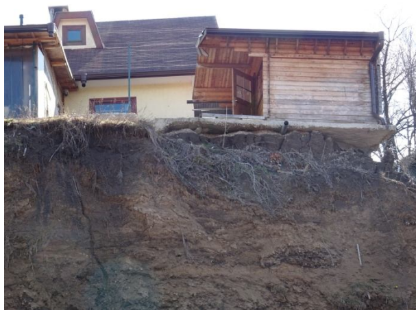
Свлачищен откос под ул. “Жан дьо Лафонтен” № 22
