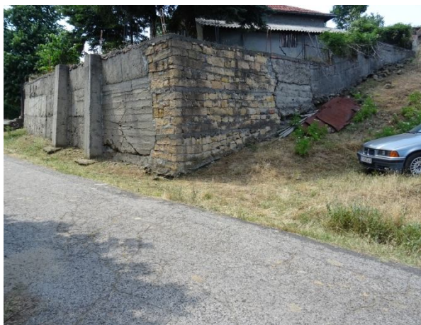
Изглед към нарушената настилка на уличното платно и деформираната подпорна стена на кметството
