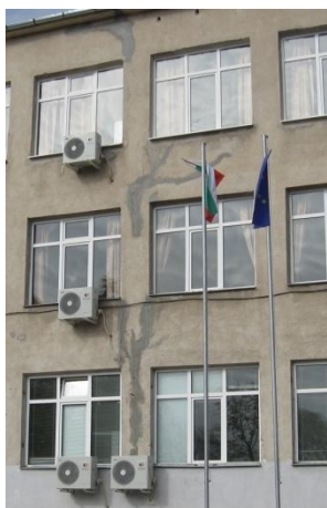
Напукана южна стена
