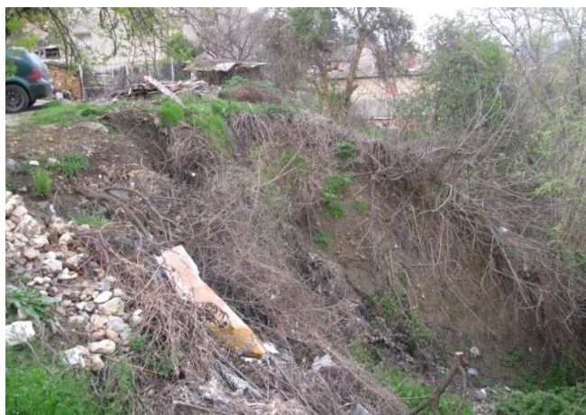
Общ изглед на свлачищния участък /2015 г./
