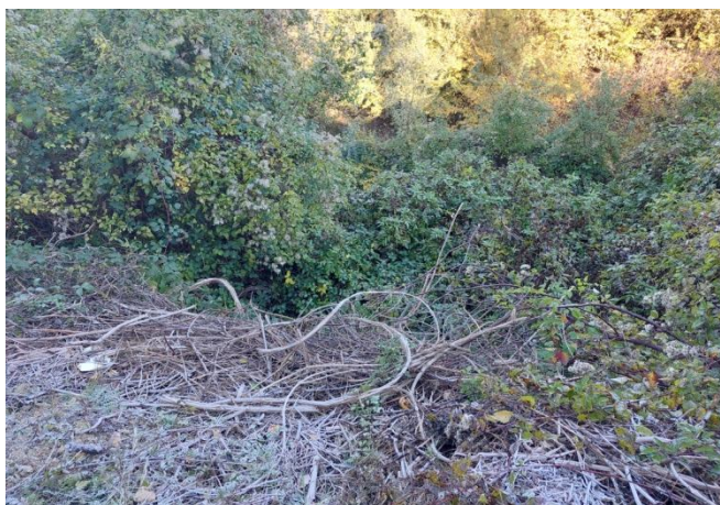
Храстовидна и дървесна растителност в свлачищното тяло
