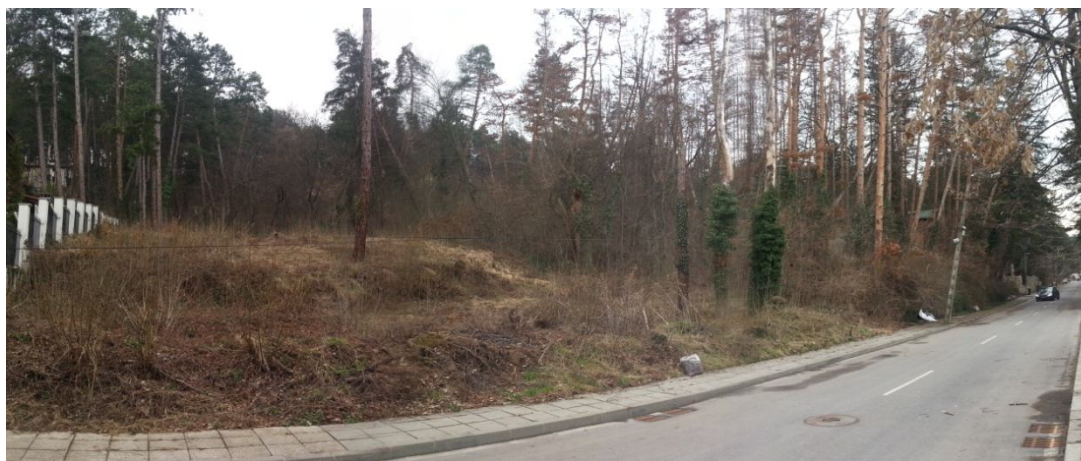
Изглед към ул. "Иларион Макариополски" и базиса на свлачищният участък /март, 2017 г./
