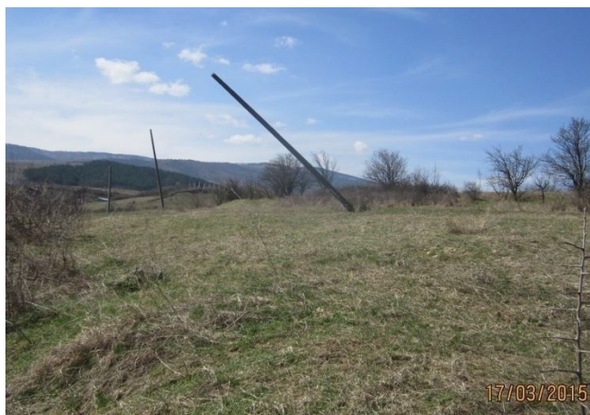
Наклонени бетонови ел. стълбове
