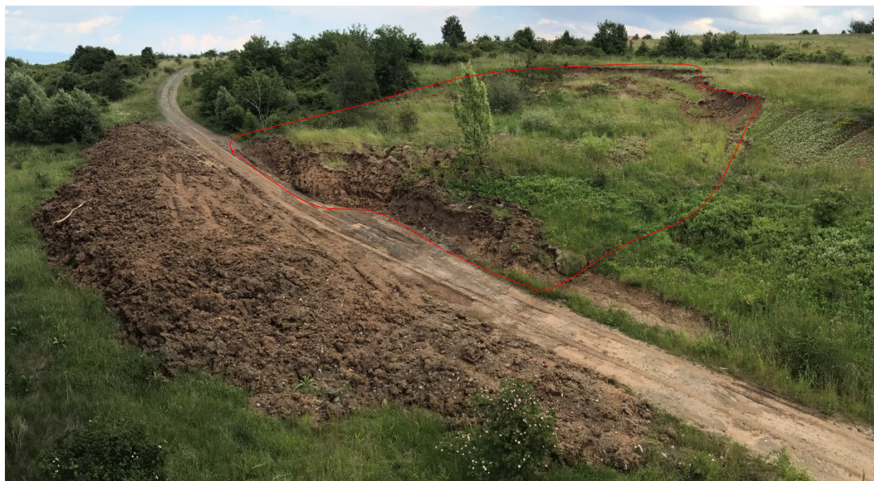
Общ изглед на свлачищния участък /18.06.2021 г./
