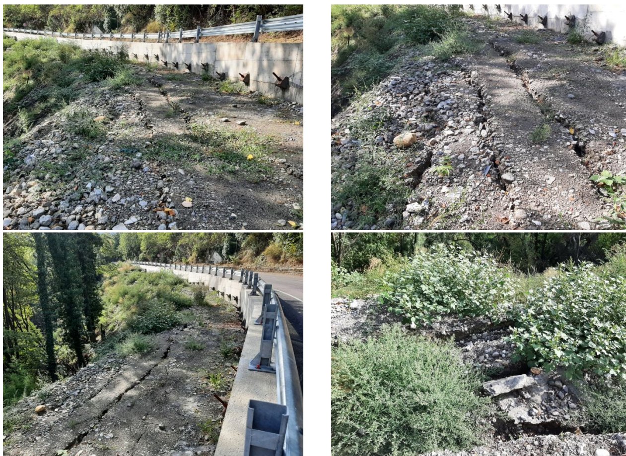
Отворени издържани денивелирани пукнатини по строителната площадка
