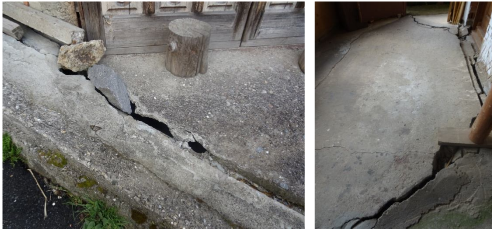
Деформации по плочата на затворената тераса в СО2
