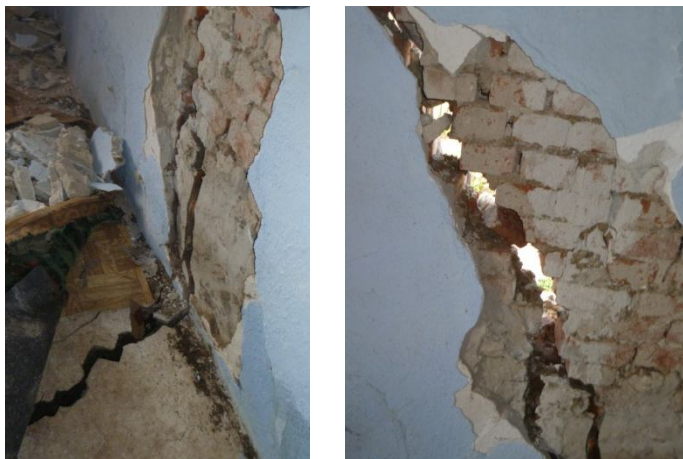
Деформации по западната стена /март, 2015 г./
