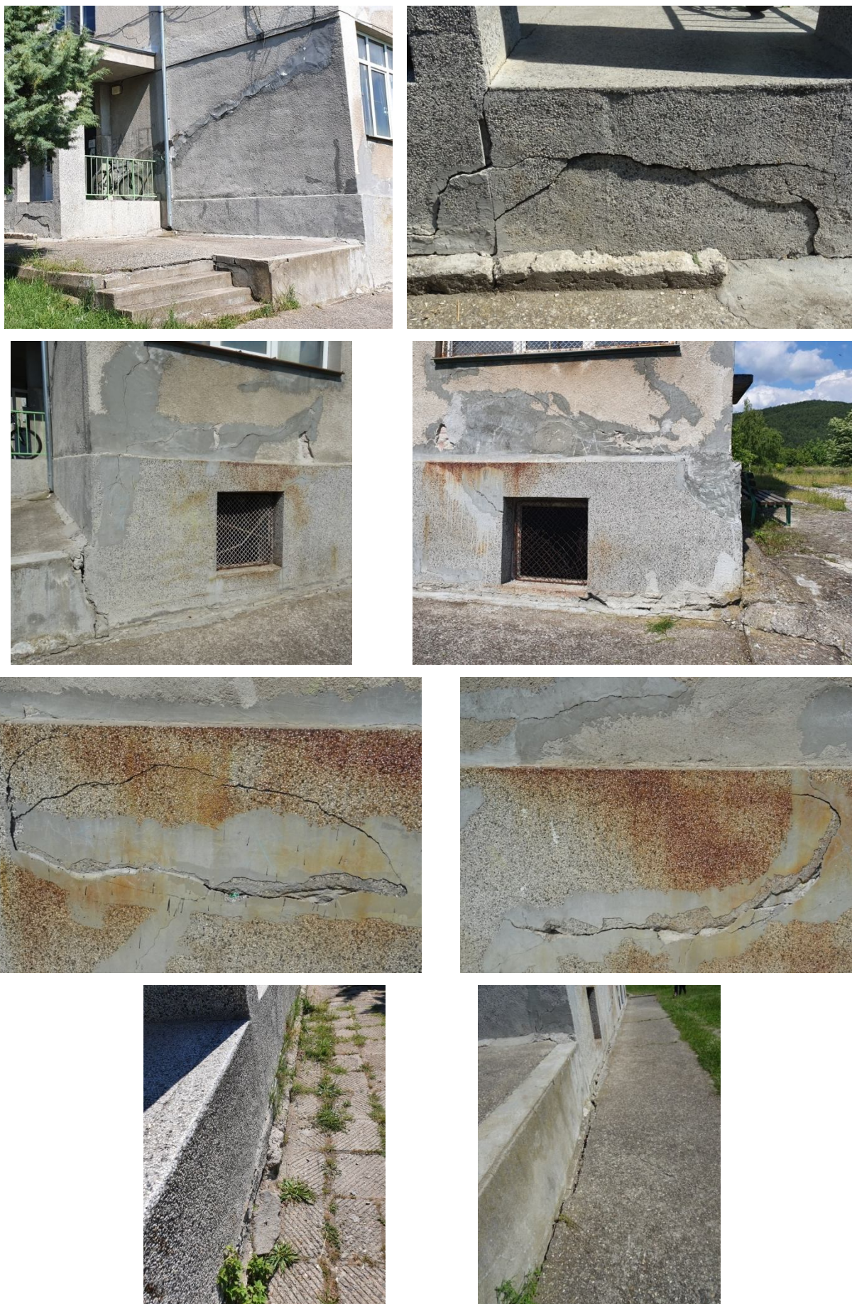
Деформации по фасадите на училището
