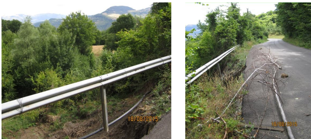
Изглед към засегнатия от свличане пътен участък
