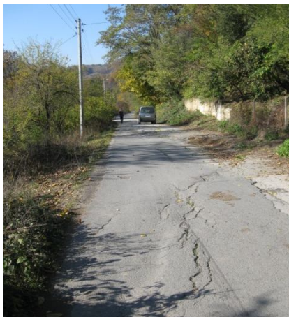
Общ изглед към свлачищния участък /2015 г./
