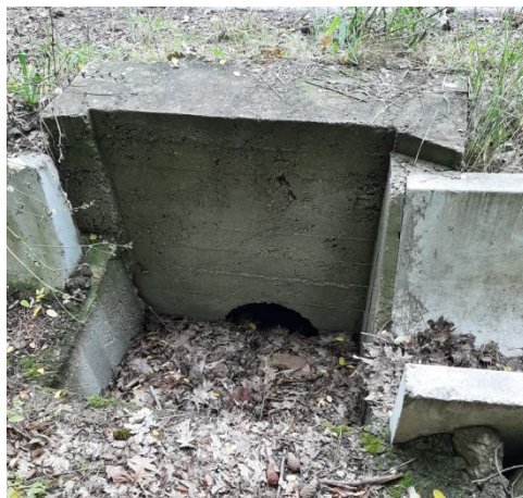
Затлачване на втока на водостока
