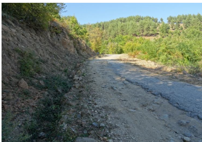
Земна „неотводнителна” канавка
