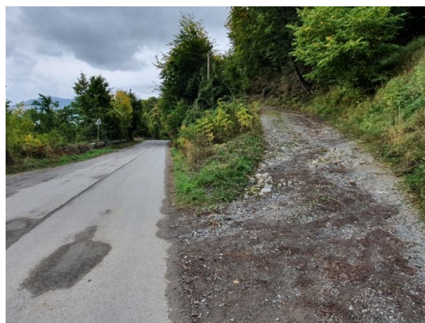
Затлачена крайпътна земна канавка
