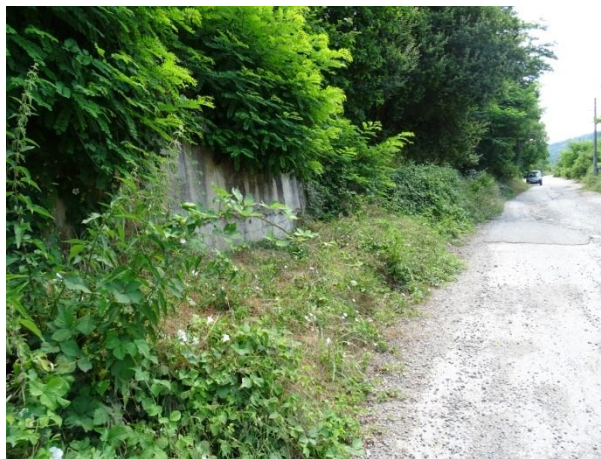
Липса на отводнителна крайпътна канавка
