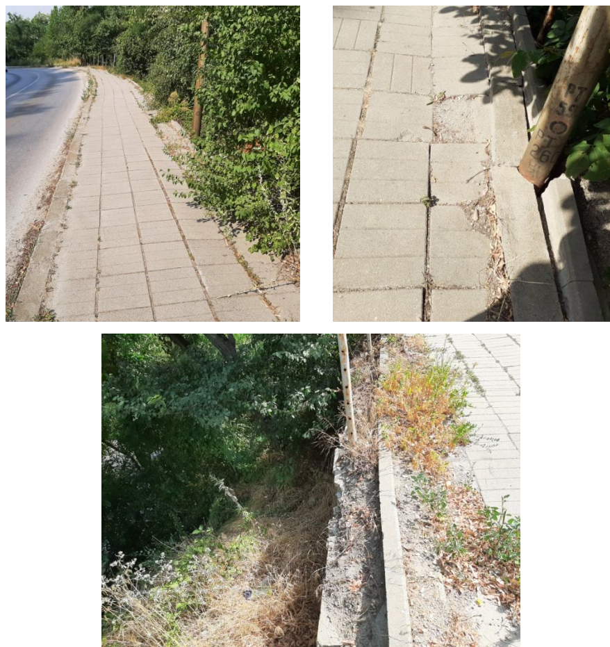
Състояние на тротоара и склона към р. Бистрица
