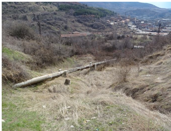
Общ изглед на свлачищния участък
