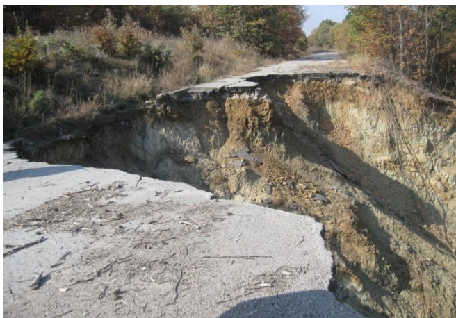
Напълно разрушено пътно платно /2015 г./
