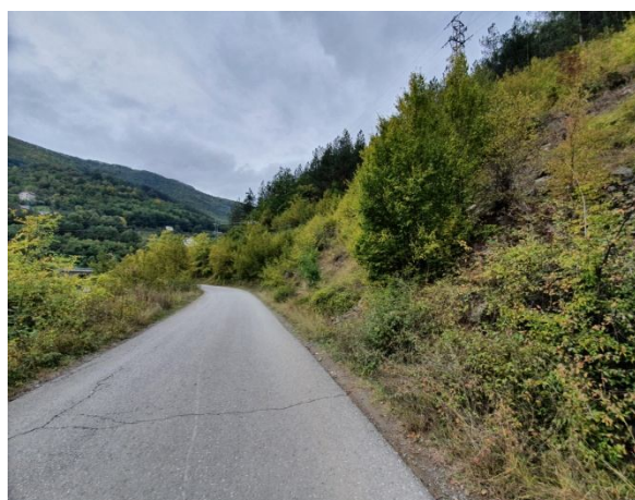
Състояние на свлачищния участък
