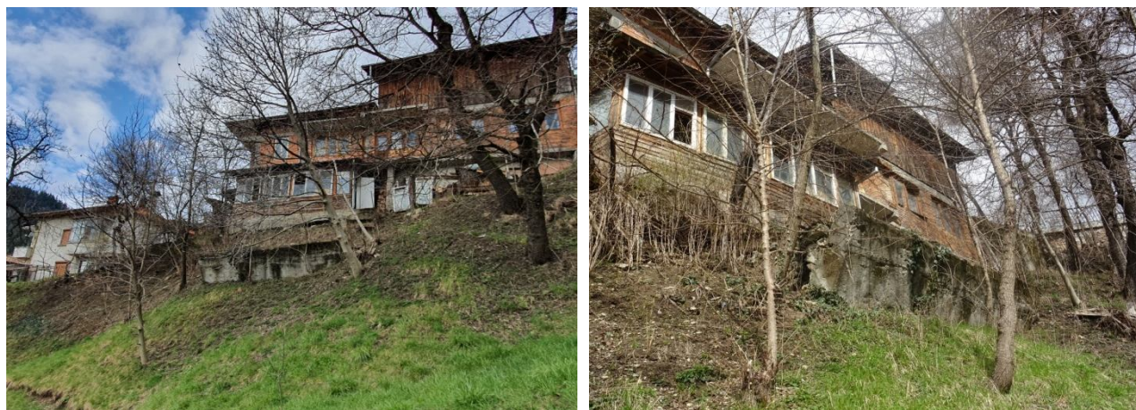
Наклонена и деформирана стара подпорна стена
