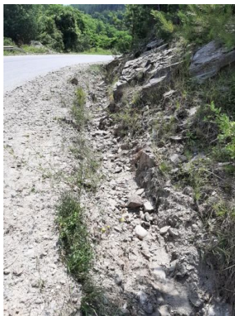
Земна отводнителна канавка
