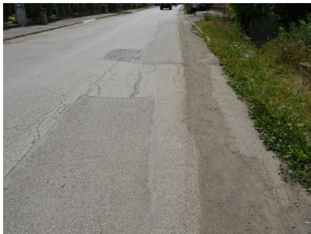
Състояние на уличното платно при откоса на свлачището
