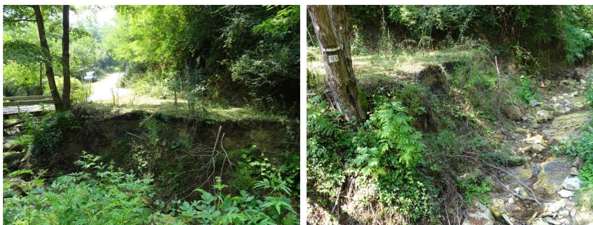
Състояние на бреговия откос при участък № 1
