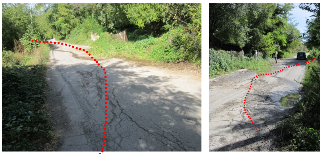
Засегнат пътен участък при km 13 +800 /2018/
