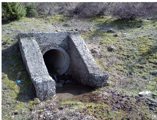
Водосток на път III-865 /март, 2015 г./
