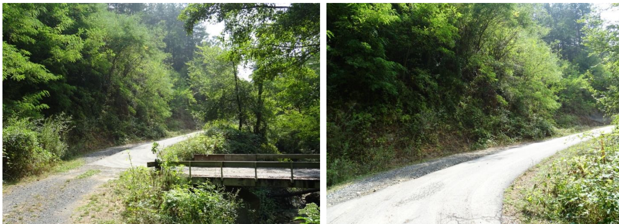
Състояние на бреговия откос при участък № 2
