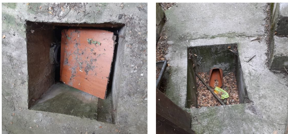
Състояние на Ш1 (вляво) и Ш2 (вдясно)
