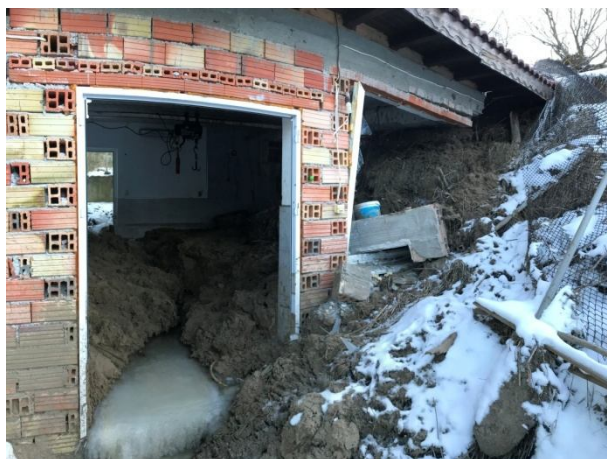
Нарушена стопанска сграда
